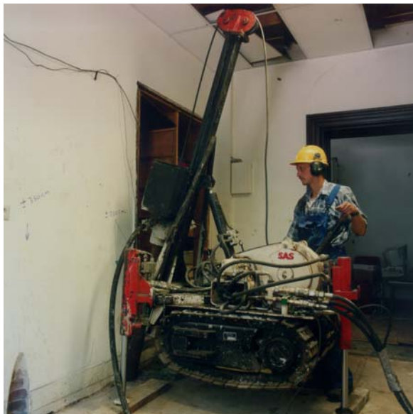
het maken van de palen binnen het gebouw met een kleine machine
