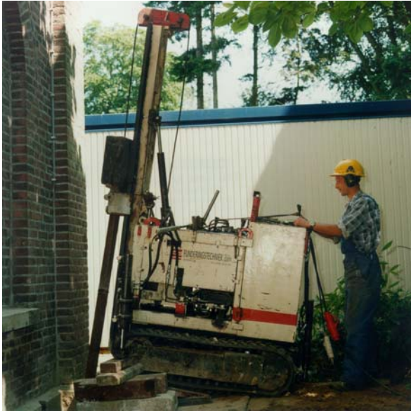
het maken van de palen aan de buitenkant met een iets grotere machine
